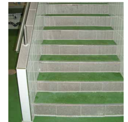
Mit dem PU-Beton lässt sich Ihr Hygienestandard flächendeckend umsetzen. Auch über mehrere Produktionsebenen hinweg.
